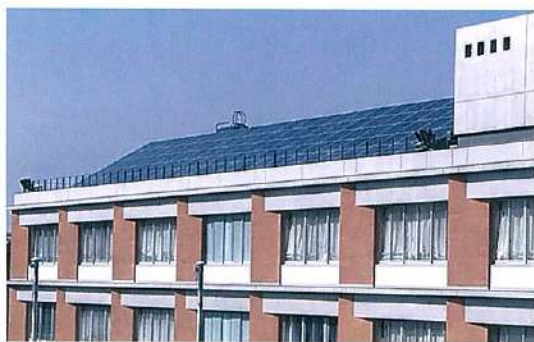
小学校に設置された太陽光パネル
